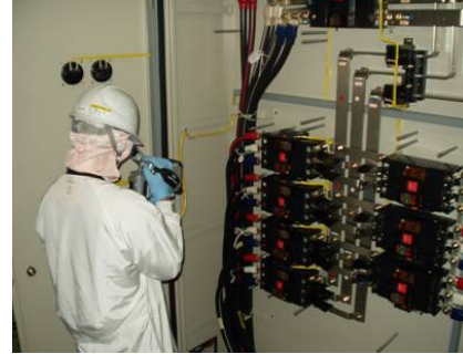
電気品の帯熱状態撮影状況
